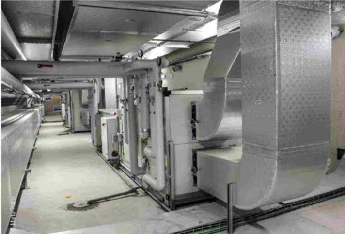
Situata al piano 5, la centrale di trattamento dell'aria è composta da 5 UTA ciascuna dedicata alla gestione indipendente delle macrozone termiche
