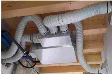
IL DEUMIDIFICATORE canalizzabile orizzontale RNW 404 è stato installato nel controsoffitto dei due piani dell'abitazione
